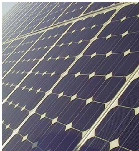
Paneles de energía solar
